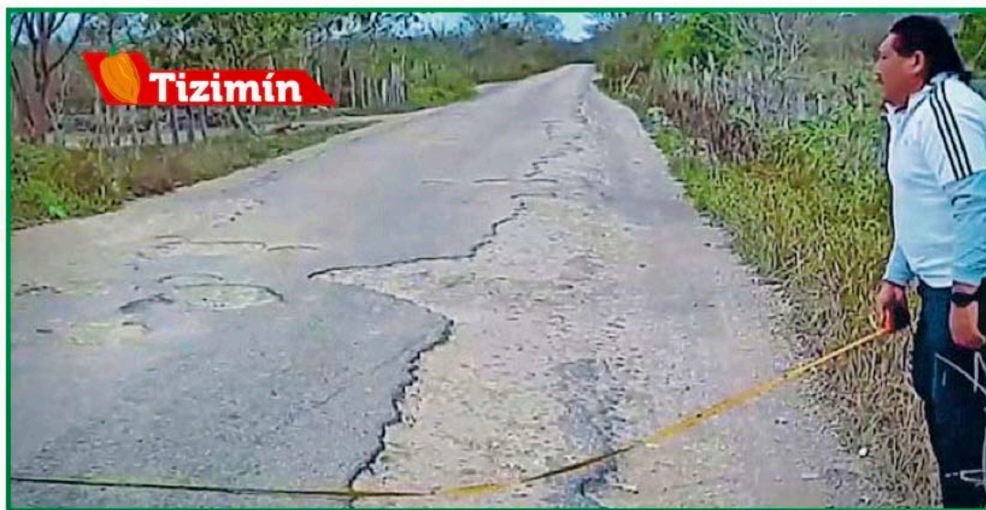
A TRAVÉS de un video el comisario mostró el avanzado deterioro de la carretera que conecta varias comunidades del oriente de Tizimín y pidió al gobierno estatal una reconstrucción integral de la vía
