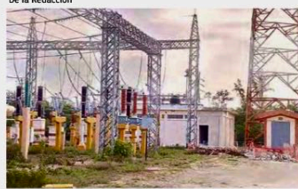
LAS dos subestaciones provisionales ayudarán a soportar el alto consumo, por los aires acondicionados, en verano.
